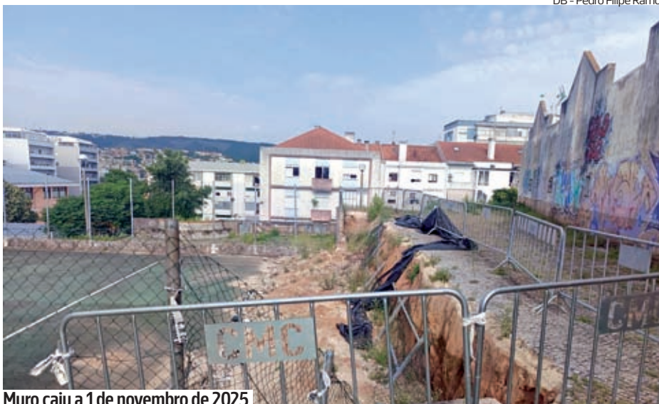
Muro caiu a 1 de novembro de 2025
